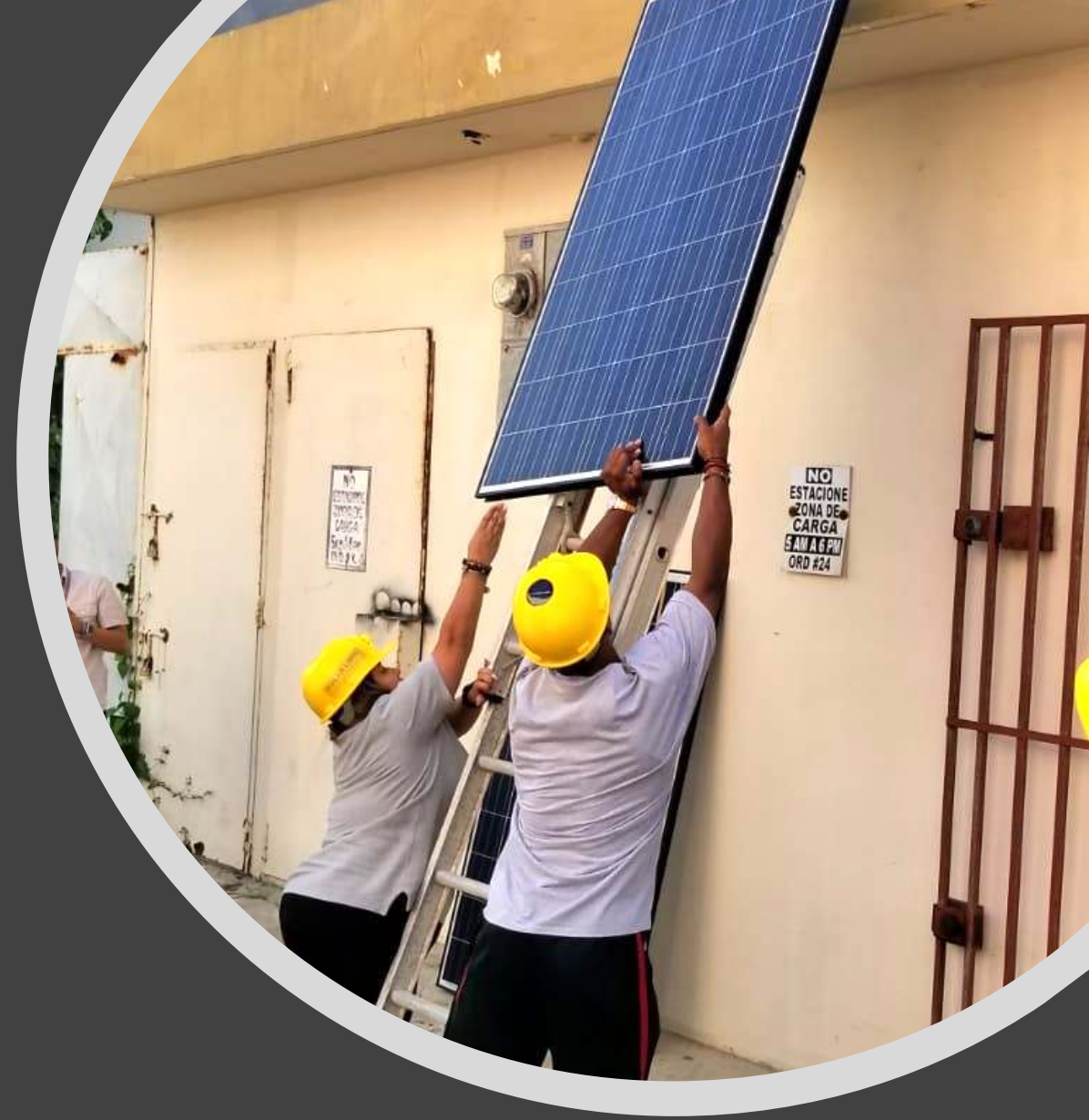
Instalación de Solar Saves Lives en MAVI, Arecibo-PR (Foto: Hispanic Federation)
